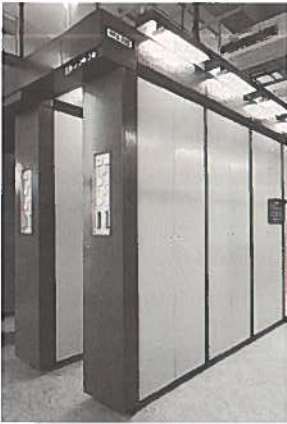
▲ Foto 11 De computergestuurde PRX-centrales met hun analoge schakeldeel zullen langzamerhand door digitale exemplaren vervangen worden.
